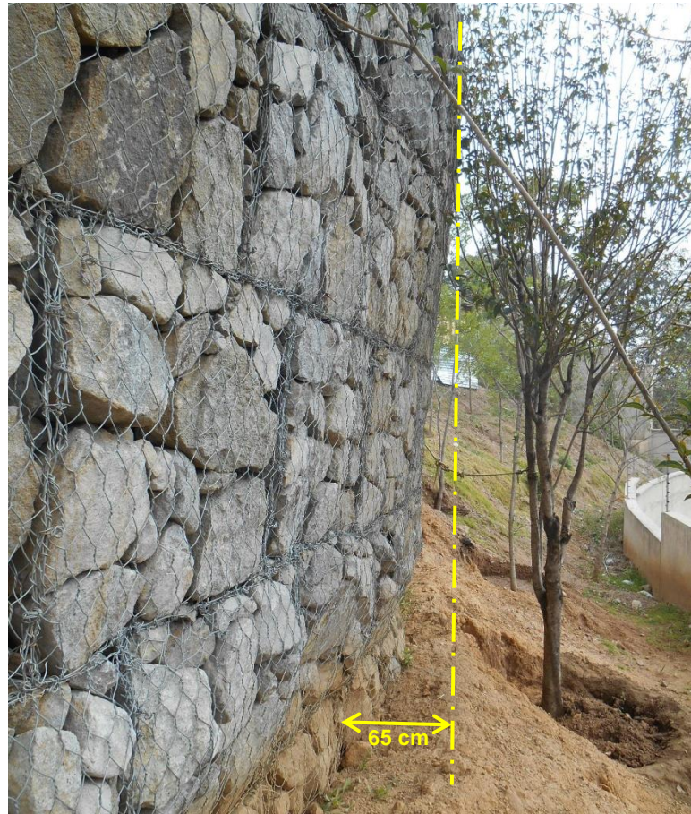
FOTOGRAFÍA 11.- LA MALA COLOCACIÓN DE LAS PIEDRAS DENTRO DE LOS GAVIONES GENERA SUS DEFORMACIONES. EN ESTE CASO SE PRESENTA UN DESPLOMO DEL ORDEN DE LOS 65 cm.
