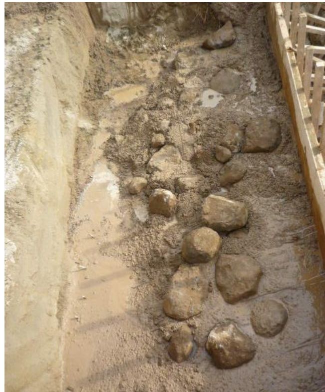
FOTOGRAFÍA 14.- ROCAS AVENTADAS DURANTE EL COLADO DE UNA SECCIÓN DE UN MURO DE CONCRETO CICLÓPEO.
