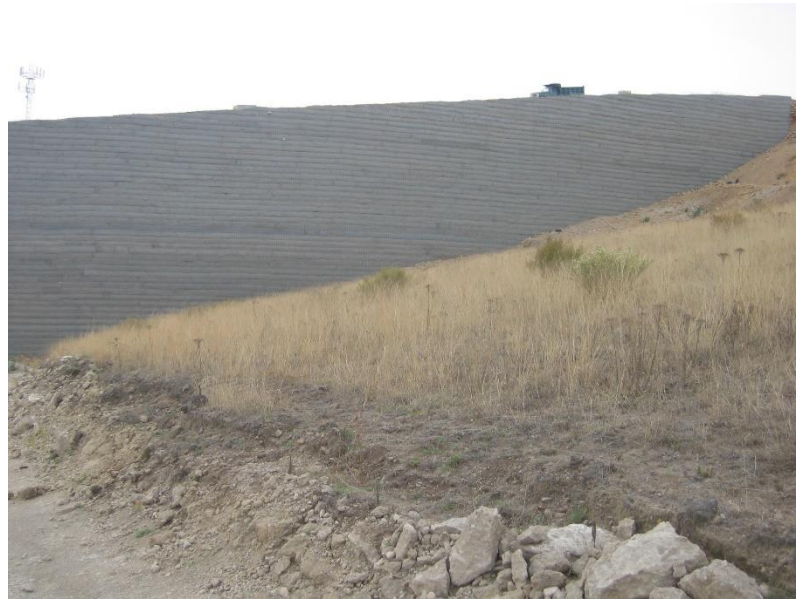
FUENTE: CORTESÍA DE MUROS TAI FOTOGRAFÍA 29.- MUROS MECÁNICAMENTE ESTABILIZADO, REFUERZO METÁLICO. VIALIDAD LOMAS VERDES, ESTADO DE MÉXICO.
