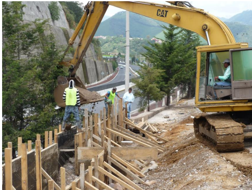
FOTOGRAFÍA 18.- COLADO DE MURO DE SUELO – CEMENTO Y BOLEOS PARA CONTENER EL RELLENO DE UNA VIALIDAD SECUNDARIA EN INTERLOMAS, HUIXQUILUCAN, ESTADO DE MÉXICO
