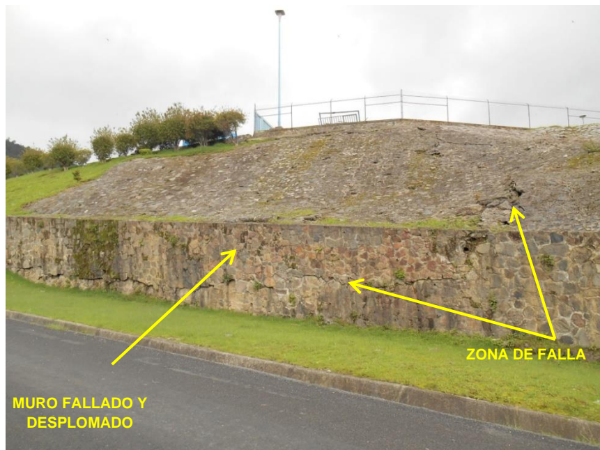
FOTOGRAFÍA 19.- LAS FALLAS MÁS COMUNES EN LOS MUROS SE DEBEN PRINCIPALMENTE A LA PRESENCIA DE AGUA EN EL RELLENO Y EN EL TERRENO DE CIMENTACIÓN. LA SEGUNDA CAUSA ES LA DEFICIENTE COMPACTACIÓN DEL RELLENO Y SU MALA CALIDAD MECÁNICA. EL CASO QUE SE ILUSTRAS CORRESPONDE A UN MURO DESPLANTADO EN UNA ZONA INESTABLE DE RELLENOS NO COMPACTADOS Y A LA FALTA DE DRENAJE.
