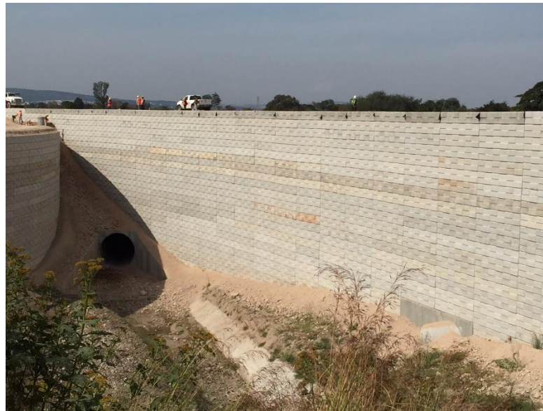
FUENTE: CORTESÍA DE MUROS TAI FOTOGRAFÍA 28.- MUROS MECÁNICAMENTE ESTABILIZADO, REFUERZO METÁLICO. LIBRAMIENTO ZAPOTLANEJO – GUADALAJARA, JAL.
