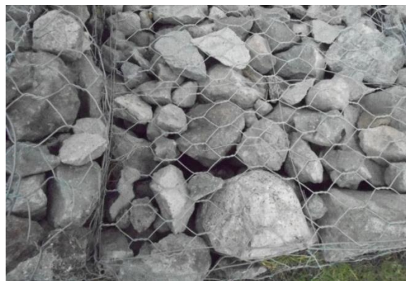
FOTOGRAFÍA 10.- EL PÉSIMO ACOMODO DE LAS PIEDRAS Y LA FALTA DE CONTROL EN SUS TAMAÑOS PROVOCAN LAS DEFORMACIONES DE LOS GAVIONES.
